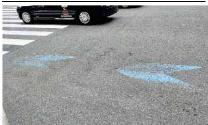
経年劣化の状況
