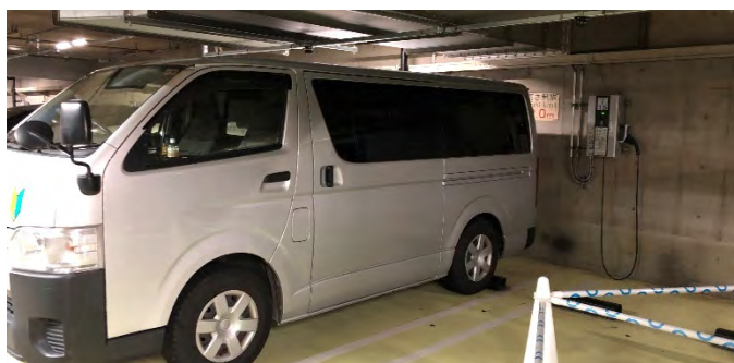
▲EV充電スタンド
