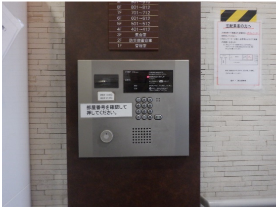
オートロックシステム（エントランス）
