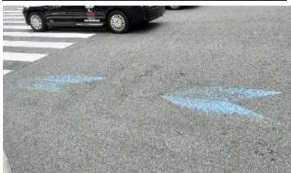
経年劣化の状況
