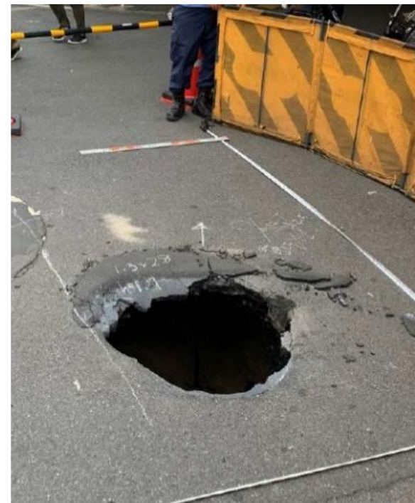
▲ 発生直後の様子 (現在は復旧対応済み)
