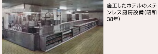
施工したホテルのステンレス厨房設備（昭和38年）
