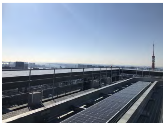
写真 4.3.2-2 太陽光パネルの設置状況
