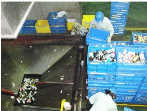
■ 資源（缶）の中間処理設備
