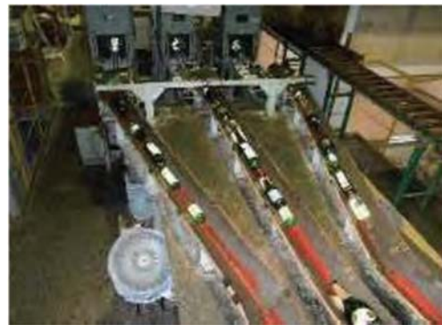
■ 資源（びん）の中間処理設備
