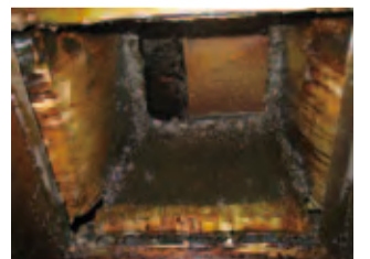
▲火災で焼けたレンジフード
