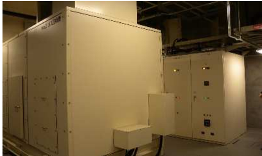
非常用発電機
