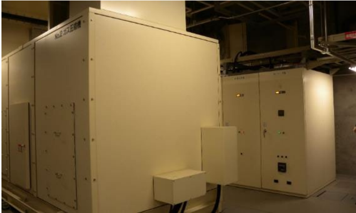
非常用発電機
