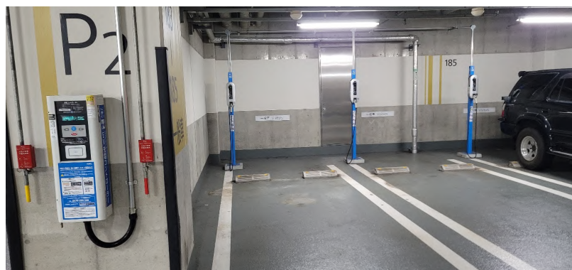
▲EV・PHV充電スタンド（東京ミッドタウン） ※令和6（2024）年9月1日時点
