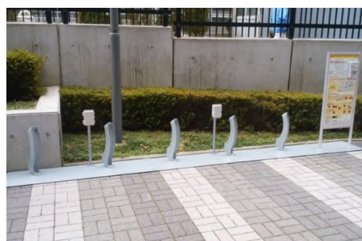
▲ポートは工事不要でラックを置くのみ
