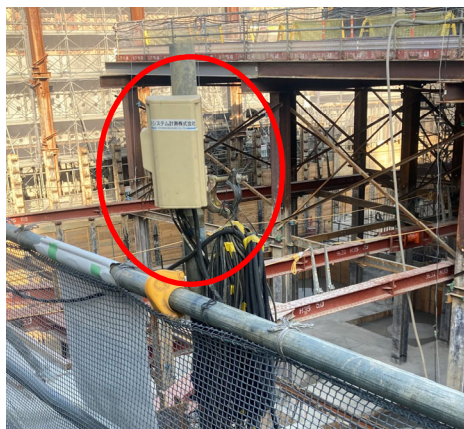
写真 4. 5. 2-2 斜傾計の設置状況
