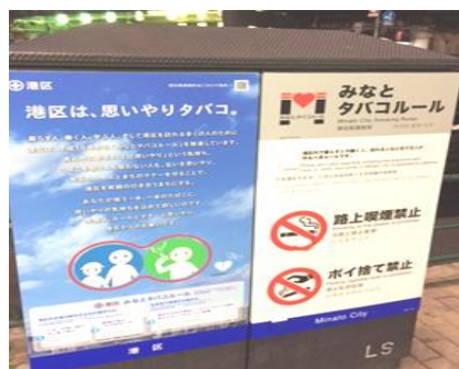
■配電ボックスの啓発表示
