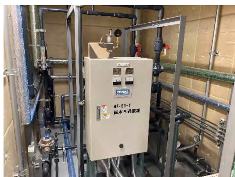
写真 4.10.1-1(1) 雨水ろ過装置
