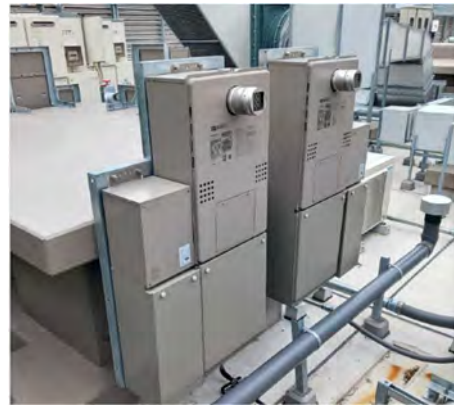
潜熱回収型ガス給湯器の採用
