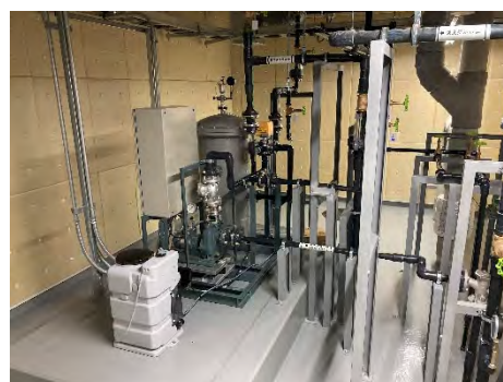
写真 4.10.1-1(2) 雨水ろ過装置（逆洗排水系統等）
