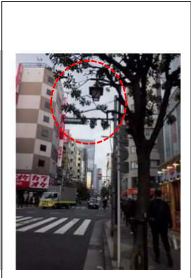
③ 車道建築限界 支障枝φ4 L1.0m 要剪定
