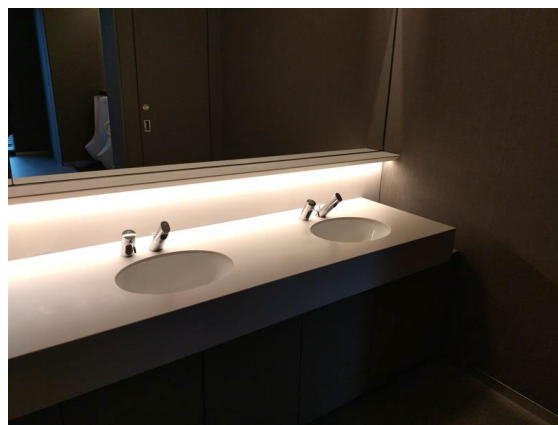
写真 4.3.2-2 照明制御の設置状況 （人感センサー）
