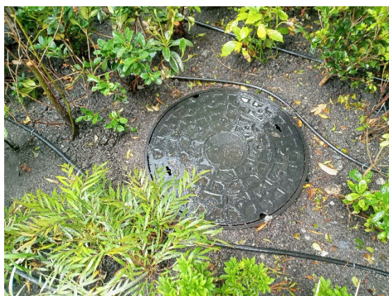
写真 4.6.2-3 外構部の散水装置（チューブ）
