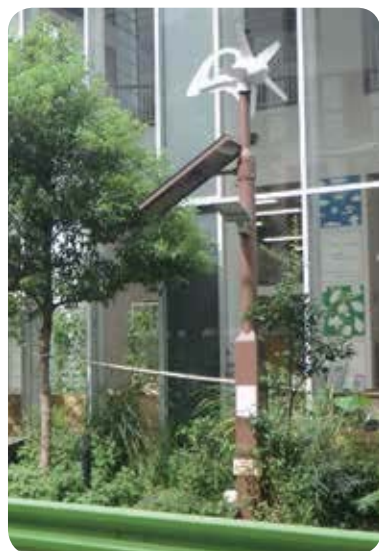
エコプラザの風力発電施設
