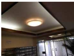
玄関ホール照明
