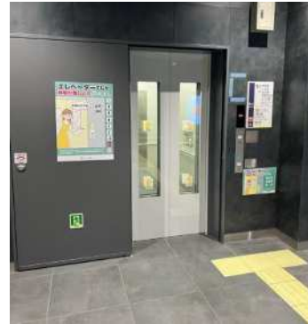
B2 改札階～B1 ホーム階のエレベーターを整備 〈東京メトロ 虎ノ門ヒルズ駅〉
