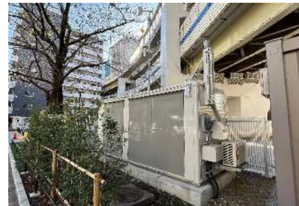
■ 一の橋測定局
