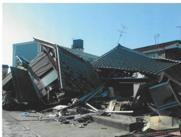
全壊した住宅 新潟県中越地震
