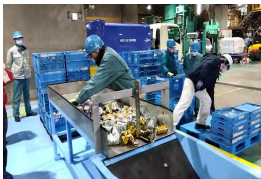
令和4（2022）年度に設備更新を行った 港資源化センター
