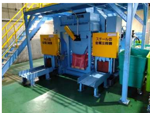
■ 資源（缶）の中間処理設備
