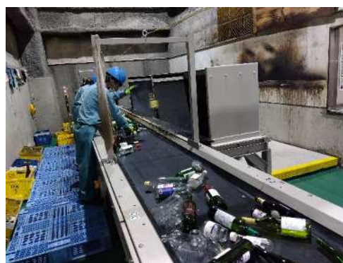
■ 資源（びん）の中間処理設備
