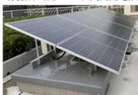
区有施設に設置した太陽光発電設備
