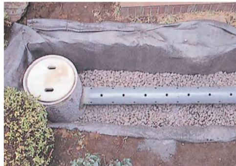
浸透管（浸透トレンチ）
