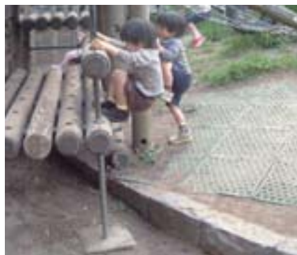
遊具のコンクリート基礎の露出などは、事故につながる危険性となる「ハザード」です。
