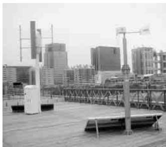
▲屋上に設置した発電装置
