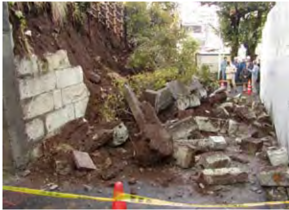
区内で発生した擁壁崩落現場(平成18年)
