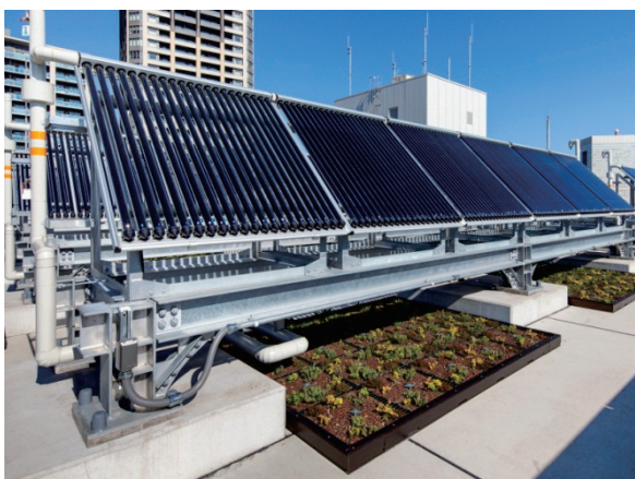
太陽光熱を利用した省エネルギー設備の設置
