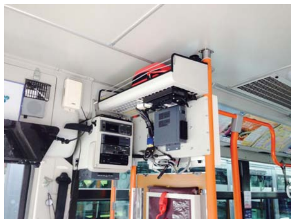
図 10-3 : A E Dの設置状況
