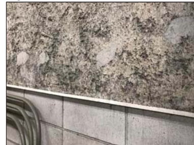
Fig. 10 内壁仕上アスベスト可能性有
