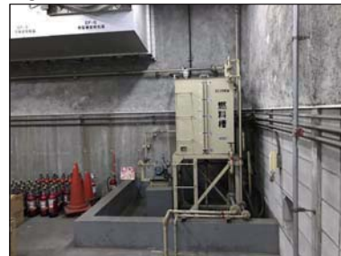
Fig. 9 内壁仕上アスベスト可能性有
