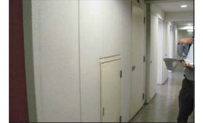
【Fig.6】パイプスペース/11階
