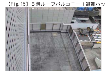
【Fig. 15】5階ルーフバルコニー1避難ハッチ ルーフバルコニー防水改修必要、避難ハッチの位置が変更済。
