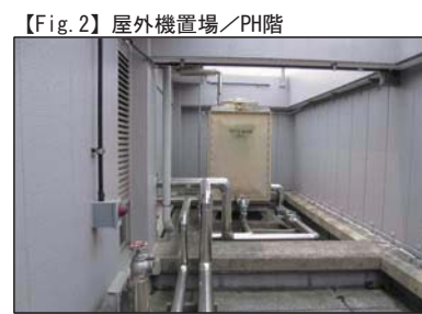
機械置場や機械基礎の防水処理や塗装仕上 に劣化、汚れあり。
