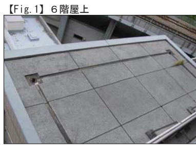
ルーフトレン、排水溝、伸縮目地劣化。
