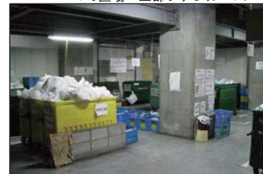
【Fig. 8】シティハイツ港南 ゴミ置場・上部ファンルーム
