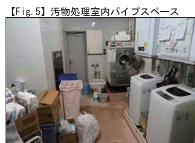
【Fig.5】汚物処理室内パイプスペース パイプスペース用扉設置済。(2~4階)
