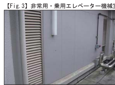
AG(アルミガラリ)あり、設備架台に腐食 あり。
