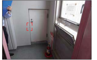
占有部バルコニー避難扉の壁面開口部に、 コンクリート欠けあり。
