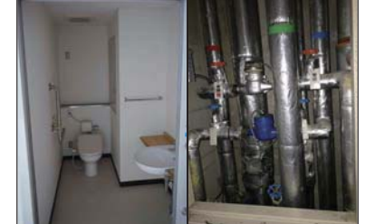
【Fig.12】夫婦居室便所内パイプスペース
