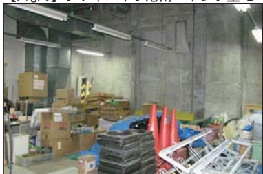
【Fig. 6】シティハイツ港南 ポンプ室-2
