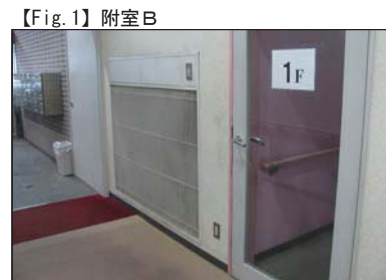
階段室内のガラリ、汚れあり。
