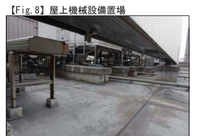
各機械基礎は各機械基礎は防水処置や塗装仕上に劣化あり。
