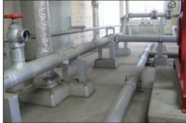
【Fig.2(2)】ブースターポンプ室
