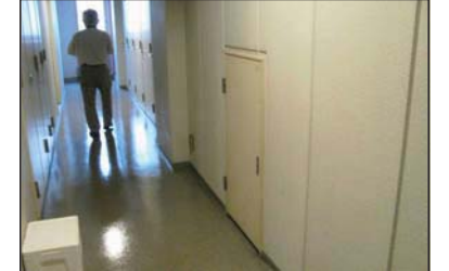
【Fig.5】パイプスペース/11階
