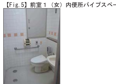
【Fig. 5】前室1(女)内便所パイプスペース パイプスペース扉、便所手すり設置済。
