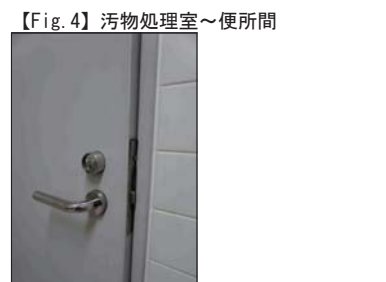
【Fig.4】汚物処理室~便所間 故障により閉じない。
