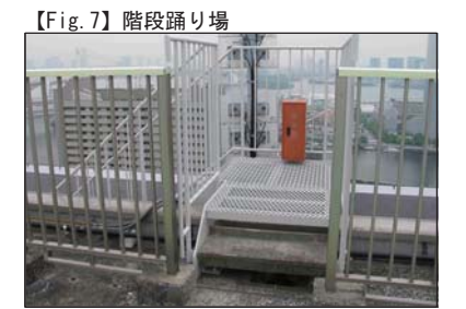
消火器BOXに腐食と文字欠けあり。
