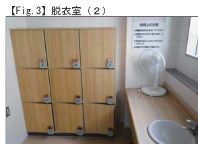
【Fig. 3】脱衣室(2) 埋込収納の個数、洗面カウンターの範囲変更済。
