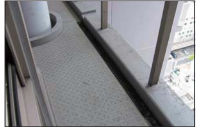
床及び排水溝に汚れあり。
