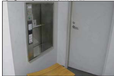
【Fig.3(1)】小荷物専用昇降機
