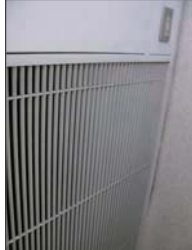
【Fig.6】附室A内ダクト用ガラリ
