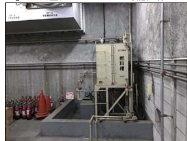
Fig.9 内壁仕上アスベスト可能性有
