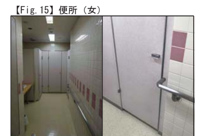
【Fig.15】便所(女) 掃除用流し設置済。(1~4階) トイレブス扉の不具合あり。
