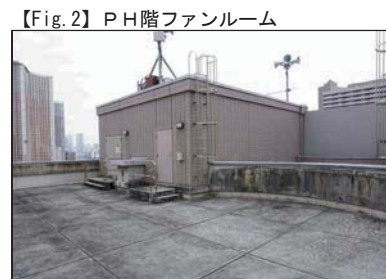
ハト小屋あり。防水処置、塗装仕上に劣化あり。
