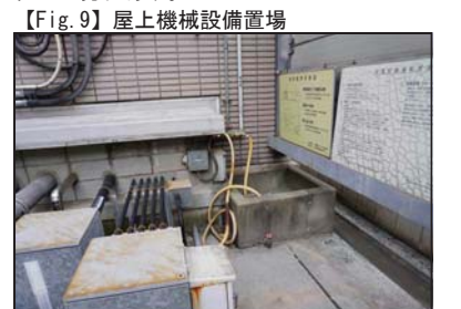
地流し・釜場あり。防水処置に劣化あり。
