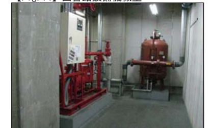
【Fig. 14】図書館設備機械室
