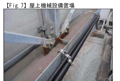
防音壁ブレード用プレート腐食あり。
