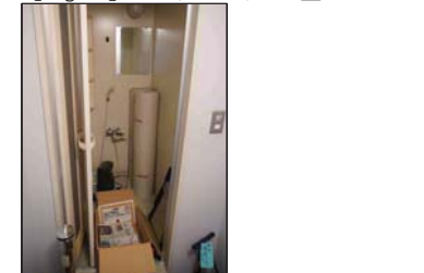
【Fig.11】 ユニットシャワー室
