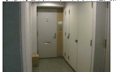
内壁や床に汚れあり。
