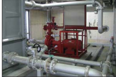
【Fig.2(1)】ブースターポンプ室
