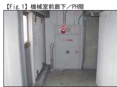
消火栓格納箱は塗装欠けあり。 外壁ALC(軽量気泡コンクリート)壁板上下 取付金物は腐食あり。
