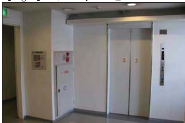
消火栓、エレベーターをみる。 内壁や天井に汚れあり。
