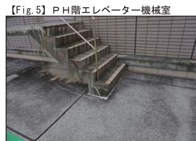
機械室への階段に白華(コンクリート劣化)があり、補修が必要。
