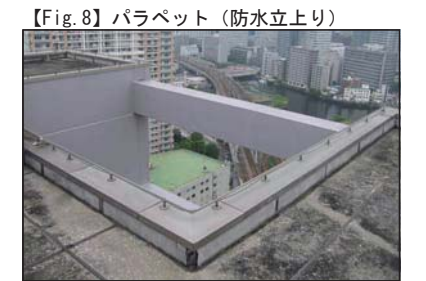
防水立上りの角部、欠けあり。
