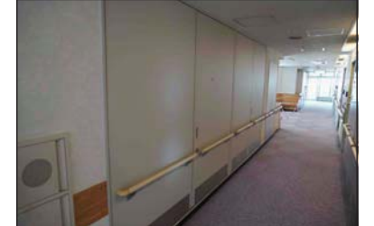
【Fig.9】電気配線シャフト
