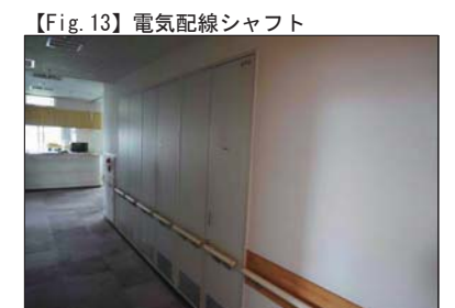
【Fig. 13】電気配線シャフト 電気配線シャフト用の扉は2箇所から3箇所に変更済。
