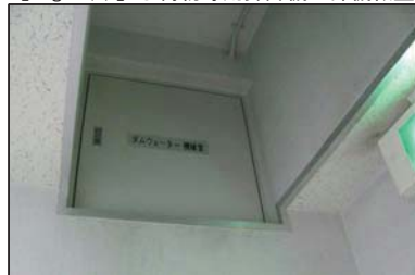
【Fig.3(2)】小荷物専用昇降機上部機械室
