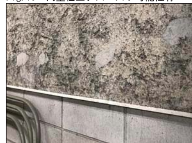
Fig.10 内壁仕上アスベスト可能性有
