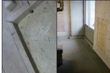
【Fig.4】ブースターポンプ室
