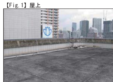
非常用扉なし。
