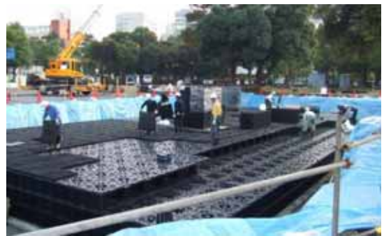
区立芝公園の地下に設置された雨水貯水槽
