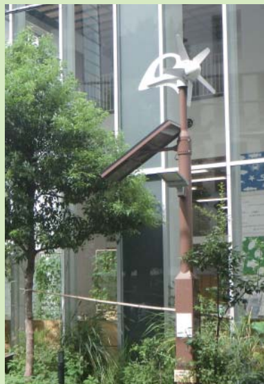
エコプラザの風力発電設備
