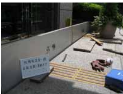
止水板（港区役所）
