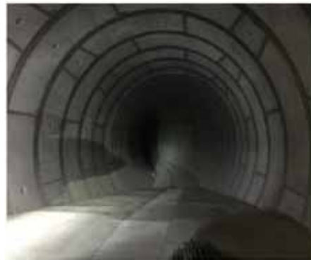
古川地下調節池
