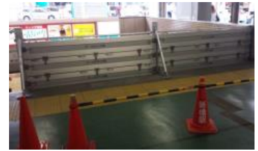
浸水防止のための止水板 (地下街出入口)
