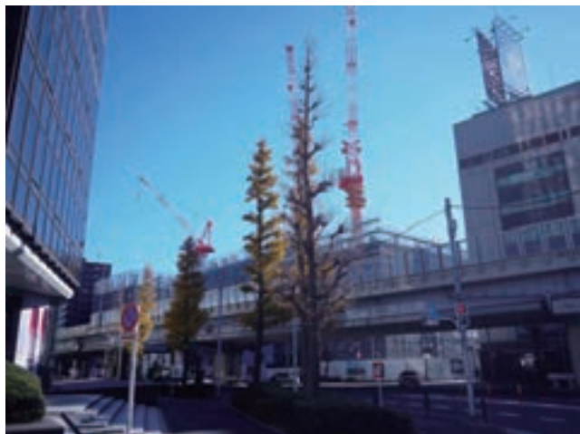
西麻布四丁目にて2024年完成予定の36階建有料老人ホーム工事中
