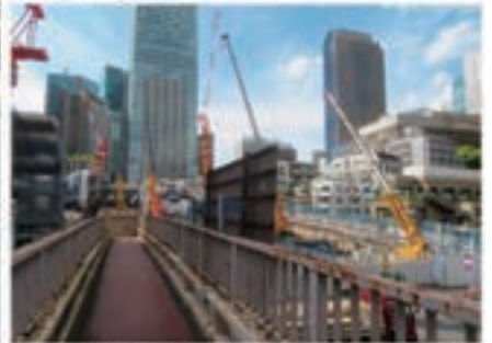
令和4年(2022年)4月:再開発地区では建物がすっかり取り払われて起重機が忙しそうに働いています。
