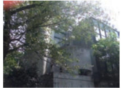
平成 21 年 (2009 年) : 作品が描かれる前の外壁部分
