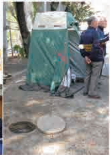
災害用マンホールトイレ
