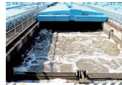
反応槽でかき混ぜられている下水
