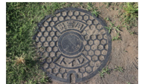
災害時にテントを張るとトイレになるマンホール
