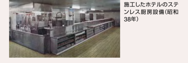
施工したホテルのステンレス厨房設備(昭和38年)
